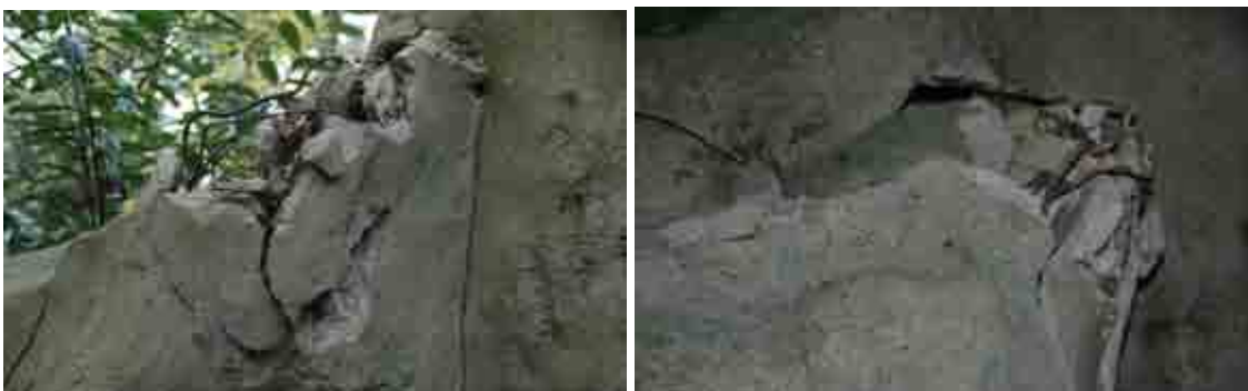
links : aan de " buitenzijde " van de rotssculptuur vrij liggend ronde & gecorrodeerde wapening, groot deel rotspleister volledig verdwenen en losse delen rondom, het geheel kunstig te restaureren conform de oorspronkelijke rotssculptuur van Octave Tondleir rechts : in het " gevelvlak " van de rotssculptuur vrij liggend ronde & gecorrodeerde wapening, groot deel rotspleister volledig verdwenen, het geheel kunstig te restaureren conform de oorspronkelijke rotssculptuur van Octave Tondleir
