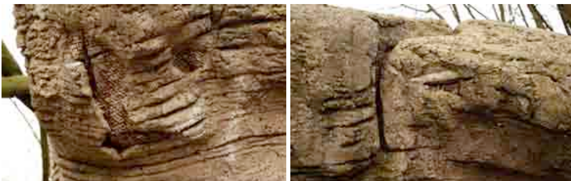
links : vrij liggend wapeningsgaas, rotspleister plaatselijk afgestoten rechts : barst- & scheurvorming & vrij liggende ijzerwapening, rotspleister plaatselijk afgestoten
