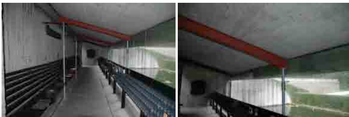
afb. 3.40 en afb. 3.41 bron © architectuurstudio de schacht & partner(s) bv ovv bvba nieuwe voorlopige steunconstructie in interieur kaarsenkapel
