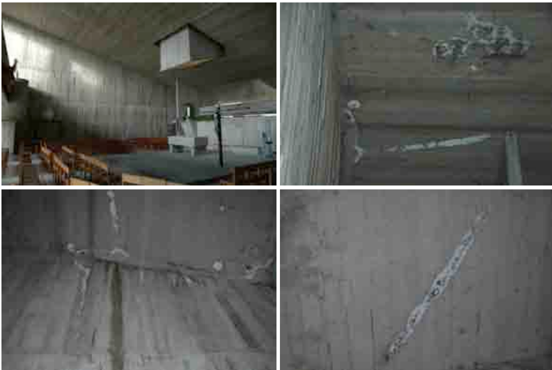
afb. 3.24, afb. 3.25, afb. 3.26 en afb. 3.27 bron © architectuurstudio de schacht & partner(s) bv ovv bvba vlekken & sporen van vocht in het interieur bedevaartkapel
