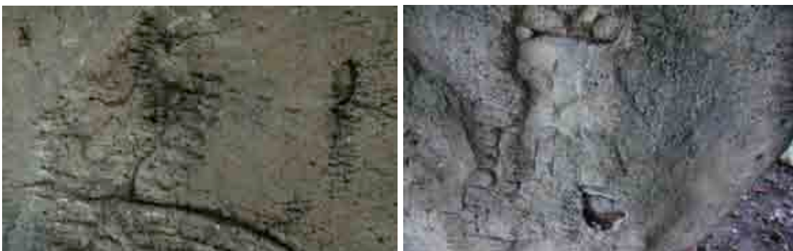
links : barstvorming & rotspleister plaatselijk afgestoten rechts : rotspleister plaatselijk afgestoten, waardoor waterindringing mogelijk wordt en roestvorming kan ontstaan op het wapeningsgaas met afstoten van de rotspleister tot gevolg
