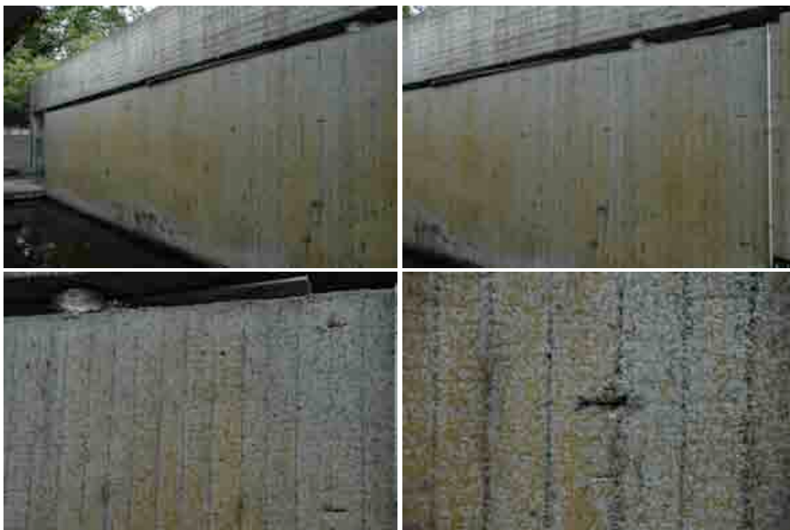
afb. 3.36, afb. 3.37, afb. 3.38 en afb. 3.39 bron © architectuurstudio de schacht & partner(s) bv ovv bvba vervuiling & aantasting wand kaarsenkapel bij tussenwater
