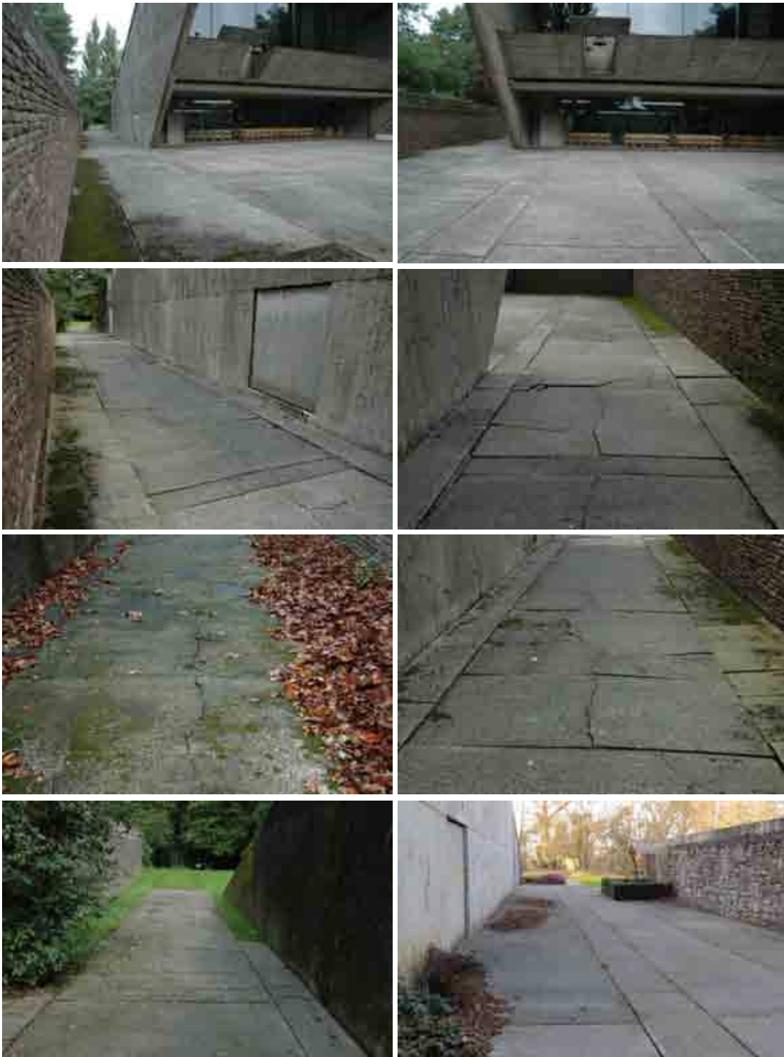
afb. 3.87, afb. 3.88, afb. 3.89, afb. 3.90, afb. 3.91, afb. 3.92, afb. 3.93 en afb. 3.94 bron © architectuurstudio de schacht & partner(s) bv ovv bvba scheur- & barstvorming in betonverhardingen d.d. 5 september 2006
